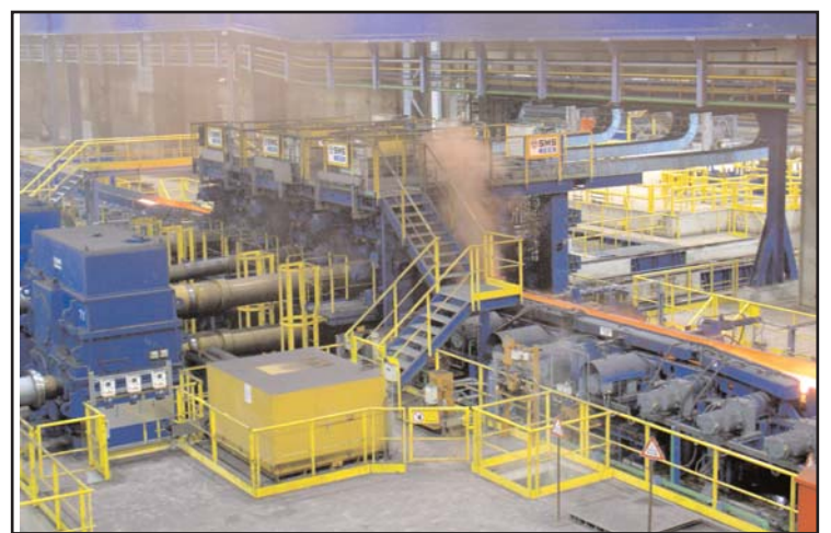
Walzgerüst der NTM-Walzstrasse
